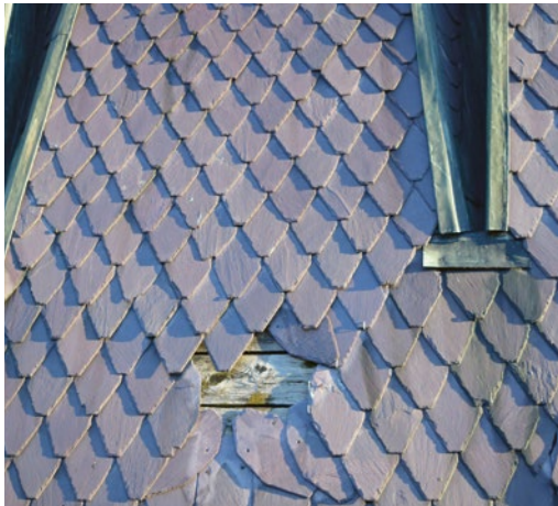
Schadhafter Kirchturm: Höchste Eisenbahn, ihn vor eindringendem Regenwasser zu schützen und neu zu schiefern!
